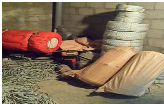
지하 급·배수 비트내 물건적치
