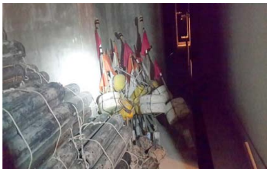
지하 급·배수 비트내 물건적치
